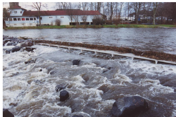
Die Kontrollstation am Siegwehr Buisdorf: Der Bereich der Kanupassage (mitte) muss umgebaut und der Leitrechen(unten) verlängert werden.
